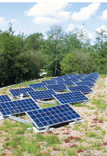
Φωτοβολταϊκά στο κάμπινγκ Κλάουζενχορν, Γερμανία
