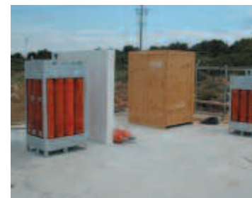
Ενδιάμεση δεξαμενή και φιάλες πλήρωσης
