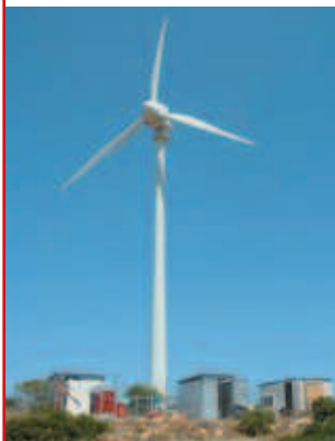
Γενική άποψη της μονάδας αιολικής ενέργειας - Ηz στο αιολικό πάρκο του ΚΑΠΕ
