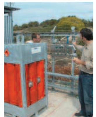
Πλήρωση ενδιάμεσης δεξαμενής (buffer tank)
