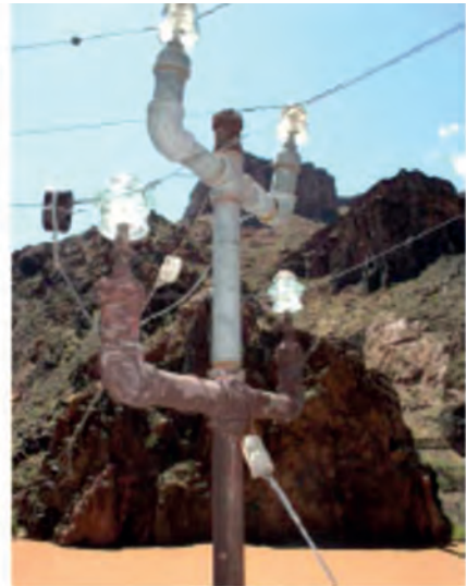
Εικόνα 5.1.α: Εγκατεστημένο τηλεφωνικό δίκτυο
