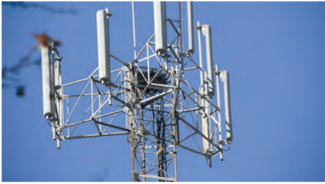
Εικόνα 2.5.β: Κεραία-σταθμός εκπομπής ασύρματου σήματος
