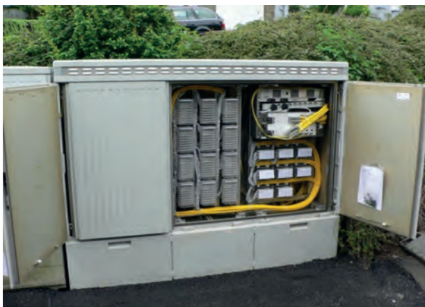
Εικόνα 5.1.4.1.β: Εξωτερικό DSLAM
