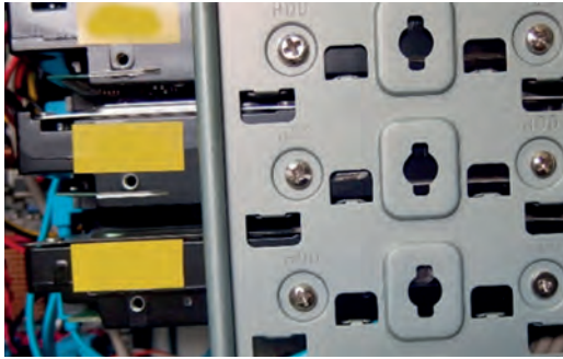
Εικόνα 31. Στήριξη μονάδων δίσκων στο πλαίσιο της θήκης
